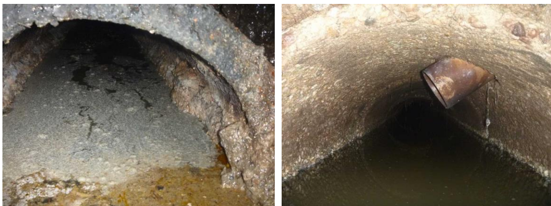
Figura 15 – Fognatura Via Naviglietto: parziale occlusione dovuta alla contropendenza
