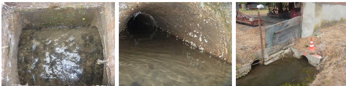
Figura 20 – Pozzetti, condotta e scarico della tombinatura di Villanova
